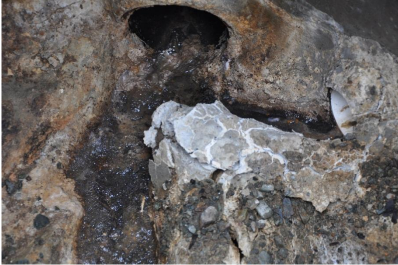
Manhole bottom broken
